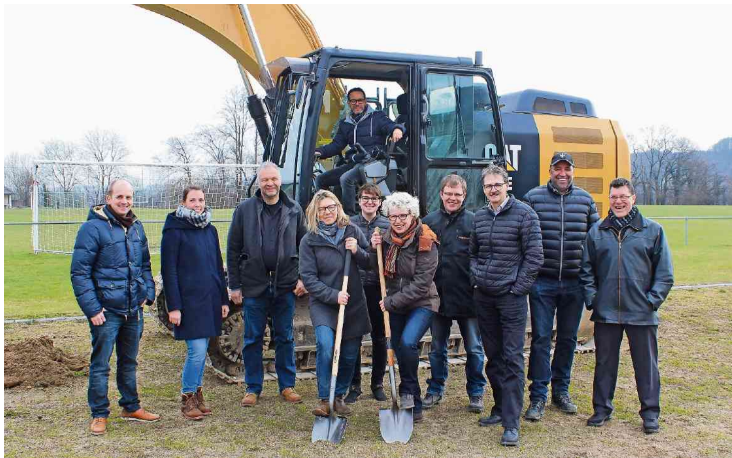
«Ein Freudentag»: Der Leiter Bau/Planung von Erlinsbach AG, David Fiore, darf ans Steuer des Baggers, während die beiden Gemeindepräsidentinnen Monika Schenker (AG. I.) und Madeleine Neumann (SO) den Spatenstich von Hand vollziehen - im Kreise von Vertretern des FC Erlinsbach, der beiden Gemeinderäte und der Planer. NADJA ROHNER
